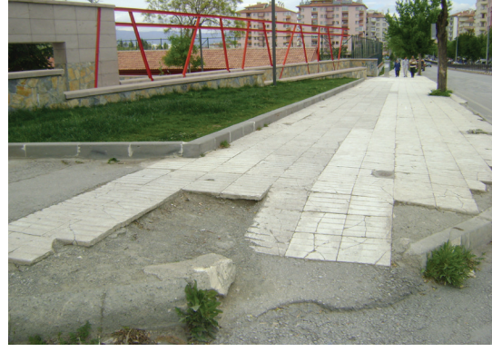
Şekil 4. Bosna Parkı A girişi önü kaldırım rampası
